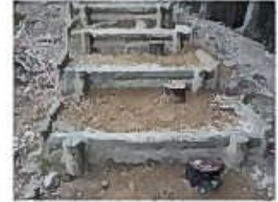
園路内の段差
