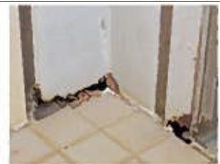
施設の老朽化（トイレ）
